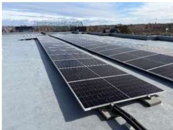
【千歳第二小学校屋上太陽光発電設備】
